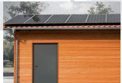
Mit integrierter Photovoltaik
